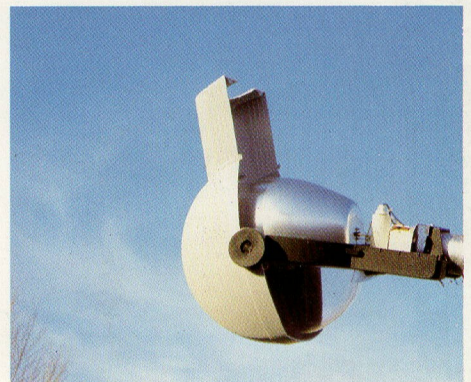
accès à l'appareillage
